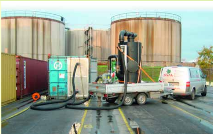
FILTERANLAGE IN BETRIEB: Im Hamburger Hafen sind Filteranlagen bei Containerbegasungen mit Methylbromid und Phosphorwasserstoff vorgeschrieben.
