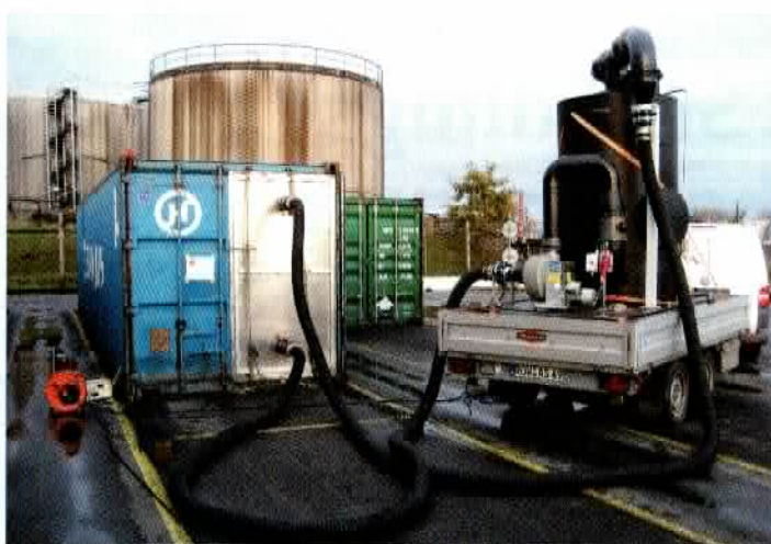
Filteranlage in Betrieb. Im Hamburger Hafen sind Filteranlagen bei Containerbegasungen mit Methylbromid und Phosphorwasserstoff vorgeschrieben. Foto: S&A
